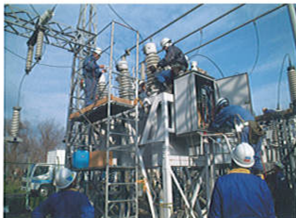
遮断器の油にじみ 部品交換
